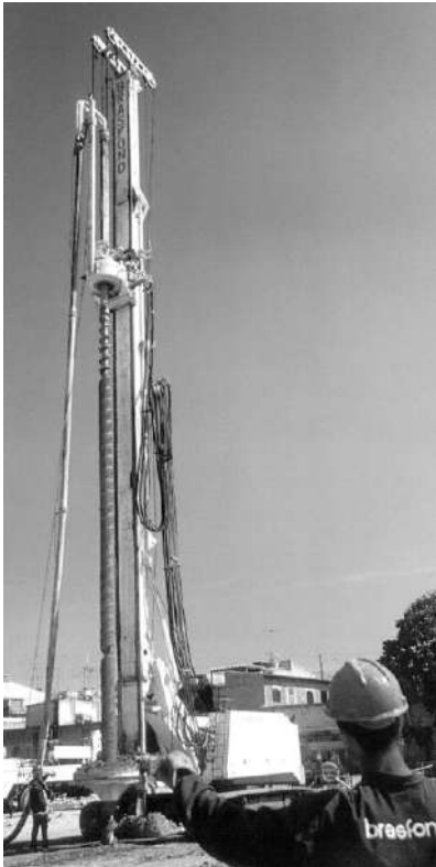
Figura 8.6 - Perfuratriz para estaca tipo hélice contínua -na foto, retirada de terra ( BRASFOND Fundações Especiais S.A.)
